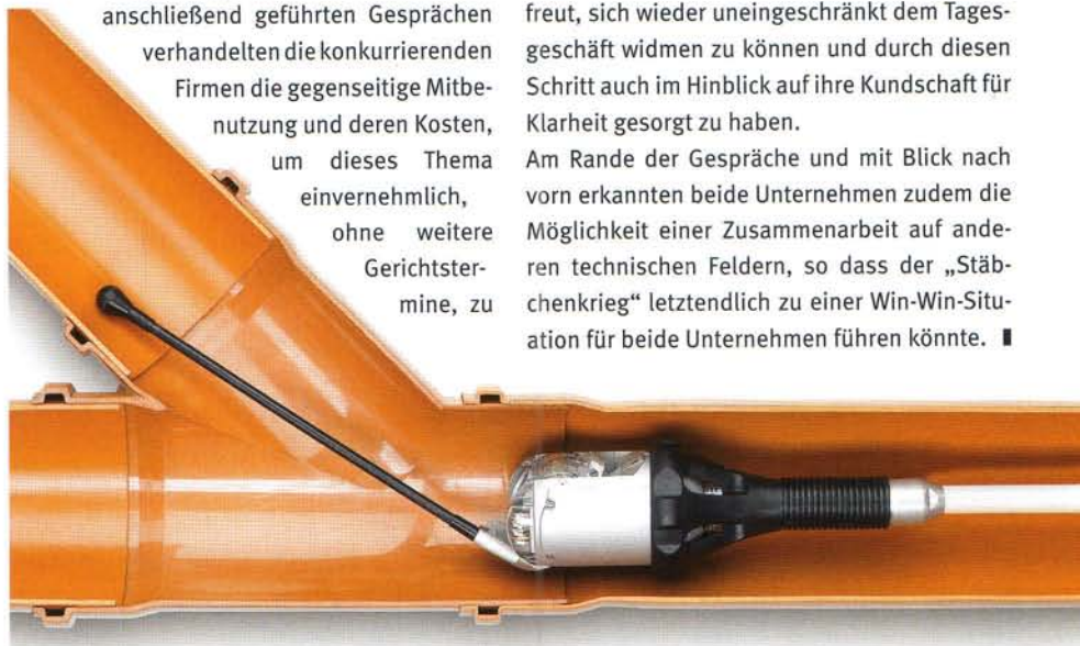
...und Kieler Stäbchen sind seit Jahren technischer Standard bei der Inspektion von verzweigten Grundstücksentwässerungsanlagen.
