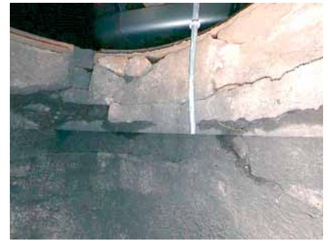
Mangelhafter Zustand der Auflageringringe
