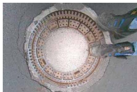
Mangelhafte Asphaltfläche um Rahmen
