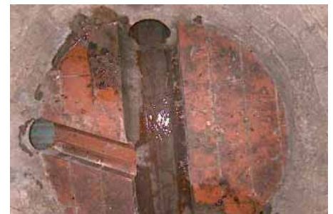
Fließendes Fremdwasser an Schachtwandung und Rohreinbindungsbereich
