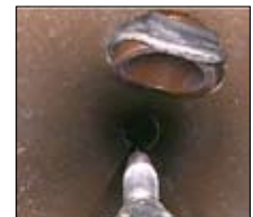
Blick gegen Fahrtrichtung auf einragendes Hindernis
