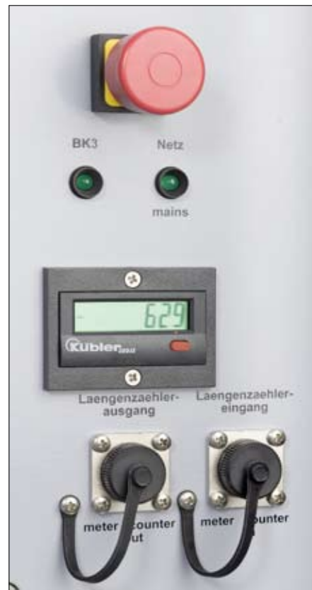
▲ IBAK KW 180, Längenmessanzeige
