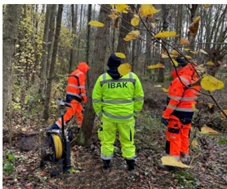
Grâce à l'installation compacte sur chariot mobile IBAK MainLite easy d'un poids de 41 kg, les services environnementaux de Bielefeld ont pu accéder à tous les puits situés en forêt, et donc réaliser une inspection complète du collecteur principal.
